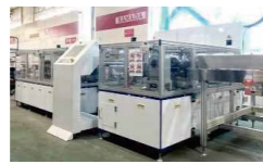
太陽光パネルリサイクル設備
