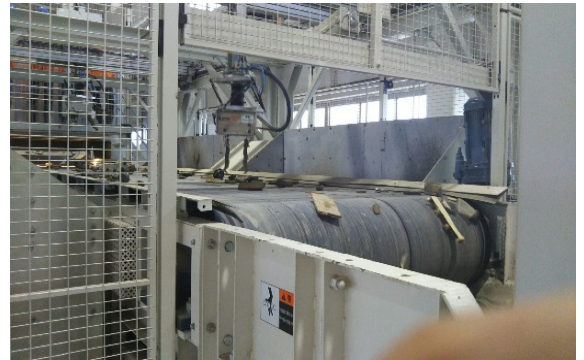
㈱シタラ興産 建廃の選別装置
